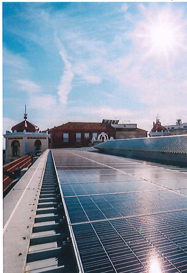
Painéis fotovoltaicos (cobertura Mercado Municipal)
