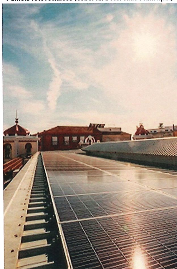
Painéis fotovoltaicos (cobertura Mercado Municipal)
