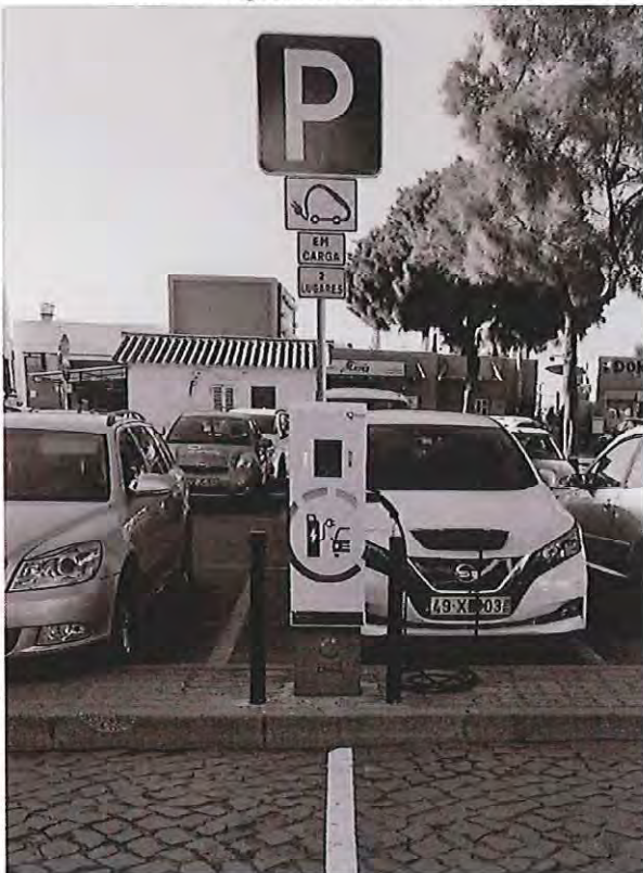
Ponto de carregamento de veículos elétricos
